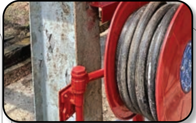
Pemeriksaan hose reel dalam keadaan baik dan berfungsi.
